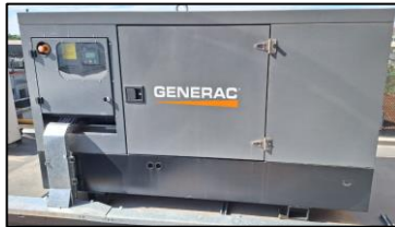
Nueva climatización y Grupo Electrónico en Libertador, con más eficiencia energética
